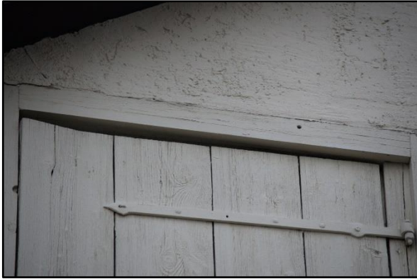
Abb. 9: Lücke über einem Holzklappladen des Mehrfamilienhauses
