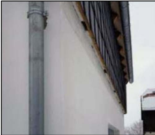
Abb. 31: Spaltenquartiere hinter Schieferverkleidung 4
