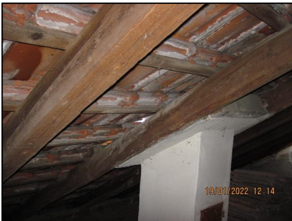
Abb. 13: Lücke zwischen Dachziegeln im Garagengebäude
