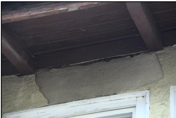
Abb. 11: Spalte zwischen Dachüberstand und Gemäuer des Mehrfamilienhauses
