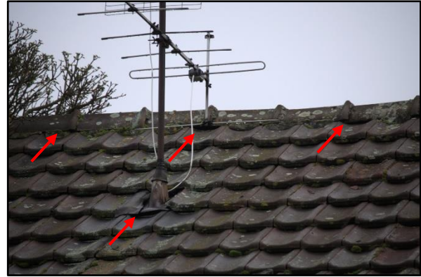
Abb. 10: Spalten unter Dachziegeln des Mehrfamilienhauses
