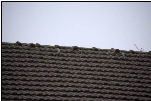
Abb. 25: Lüftungsziegel des Mehrfamilienhauses
